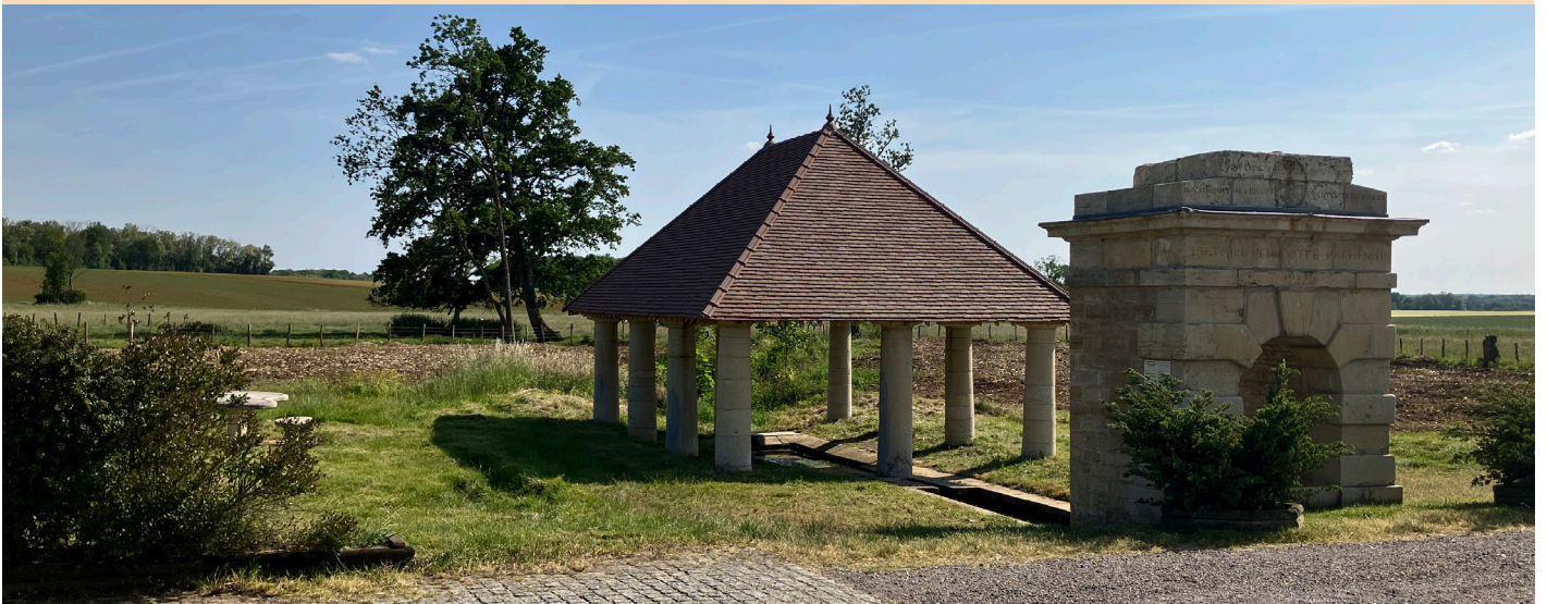
Reconstruction de la Fontaine Henri IV et nettoyage du site avant son réaménagement
