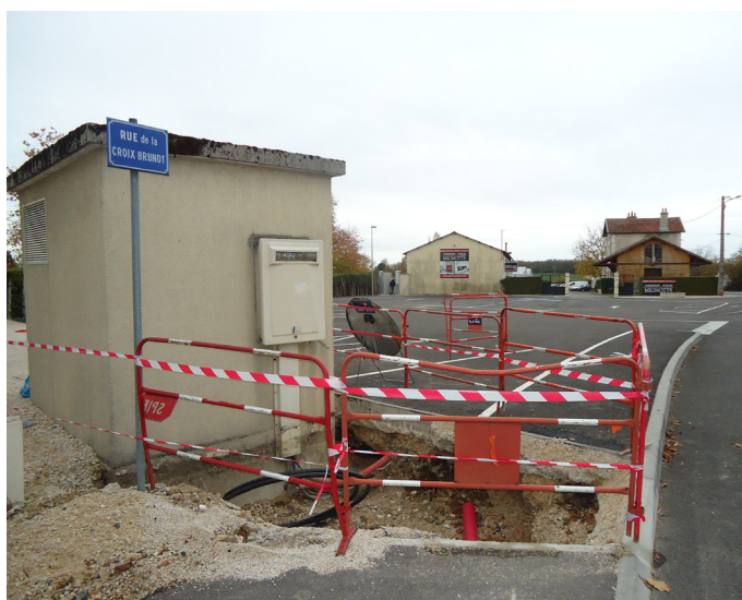
Installation d'une borne de recharge pour véhicules électriques sur le parking rue de la croix Brunot.
